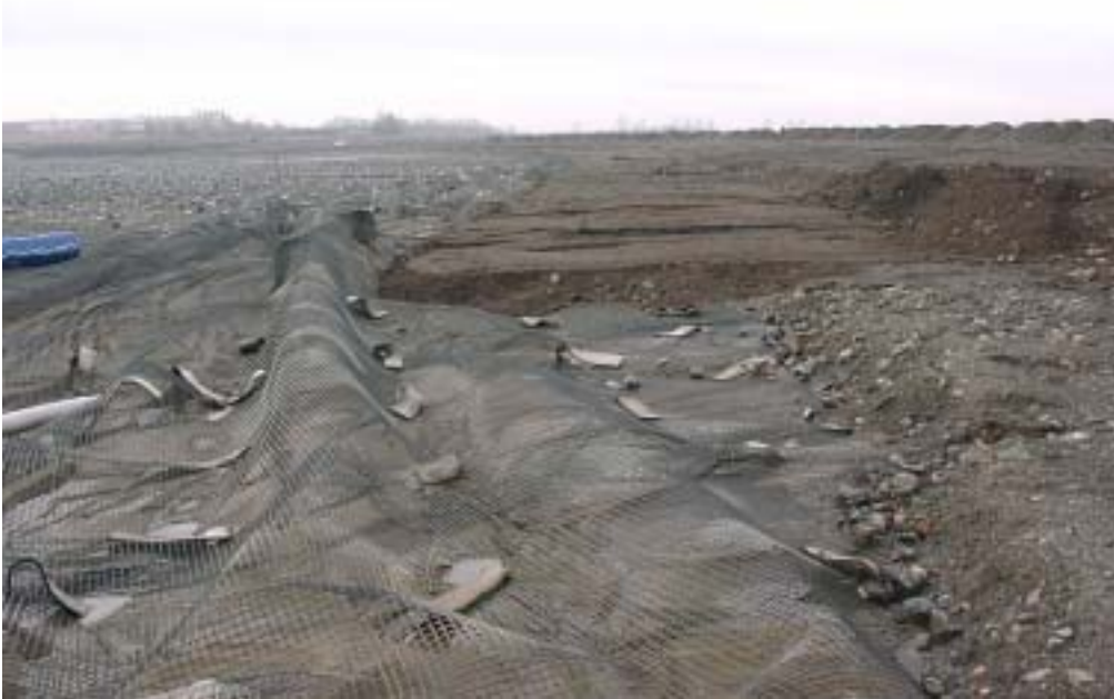
Abb. 9: Verformungen an der Verhiebslinie
