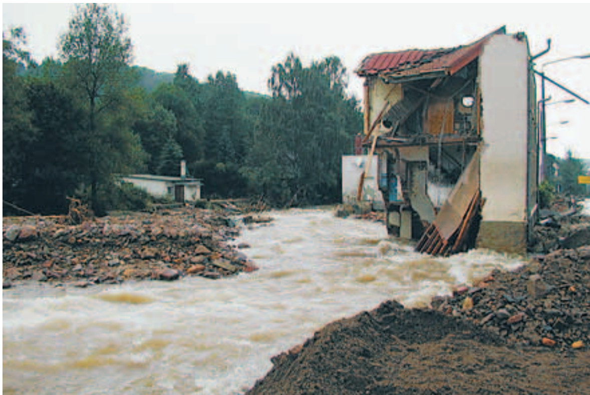
Abbildung 8: Zerstörtes Gebäude sowie Gewässer- verlagerung der Roten Weißeritz in Schmiedeberg (Foto: Gottfried Herold, 2002)
