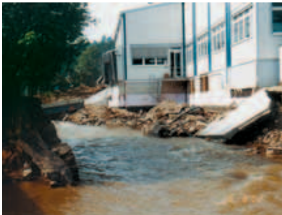
Abbildung 19: Zerstörte Ufermauer der Müglitz in Glashütte 2002 (Foto: LTV, 2002)
