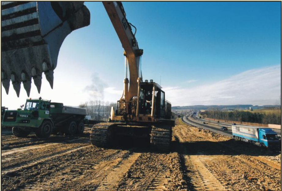
Verdichtung - eine Folge häufiger Befahrungen
