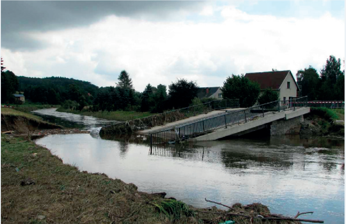
Abbildung 9-48: Zerstörte Brücke (Foto: Hr. Baldauf)
