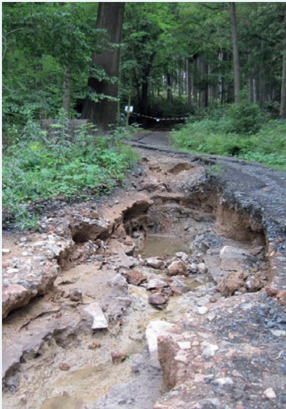
Abbildung 6-31: Schäden am Bärchelweg (Revier Jonsdorf) durch wild abfließendes Wasser während der Starkniederschläge des 06.08. und 07.08.2010 (Foto: Stadtverwaltung Zittau)
