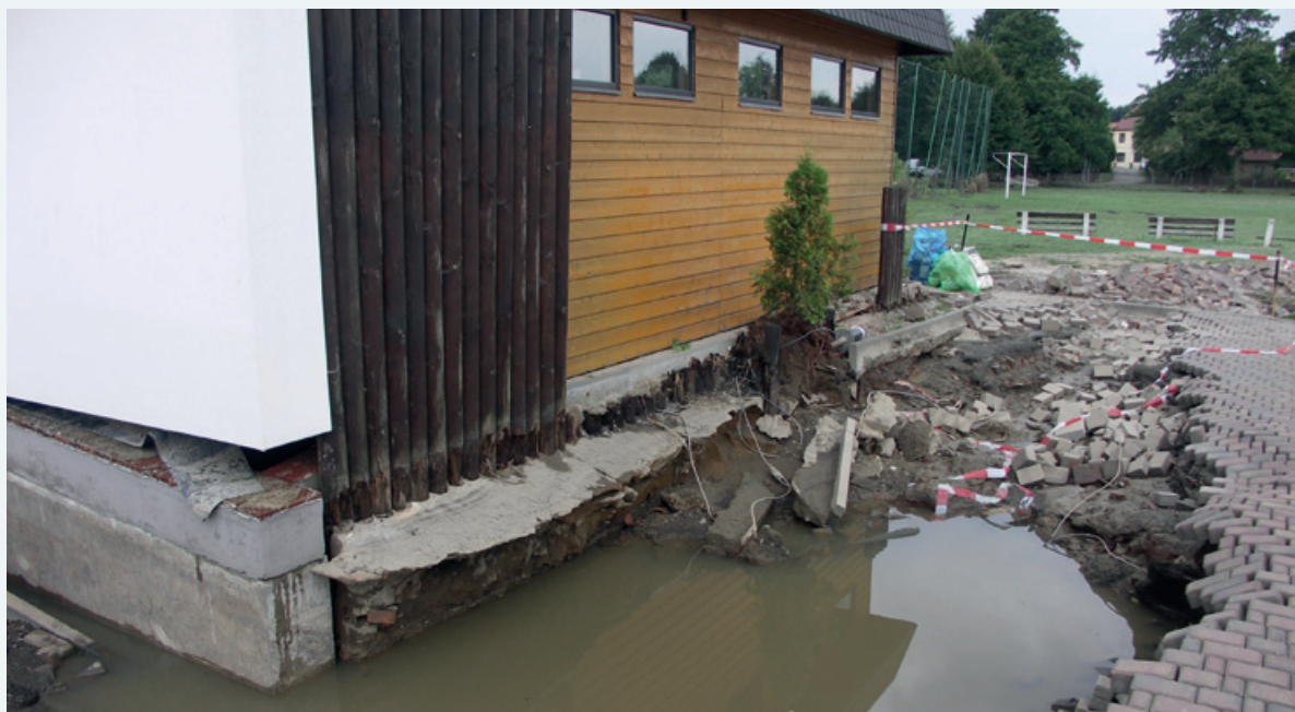
Abbildung 6-13: Tiefenerosion an einem Fußweg in Lodenau und abgesacktes Fundament eines unterspülten Gebäudes (Foto: Landratsamt Görlitz)
