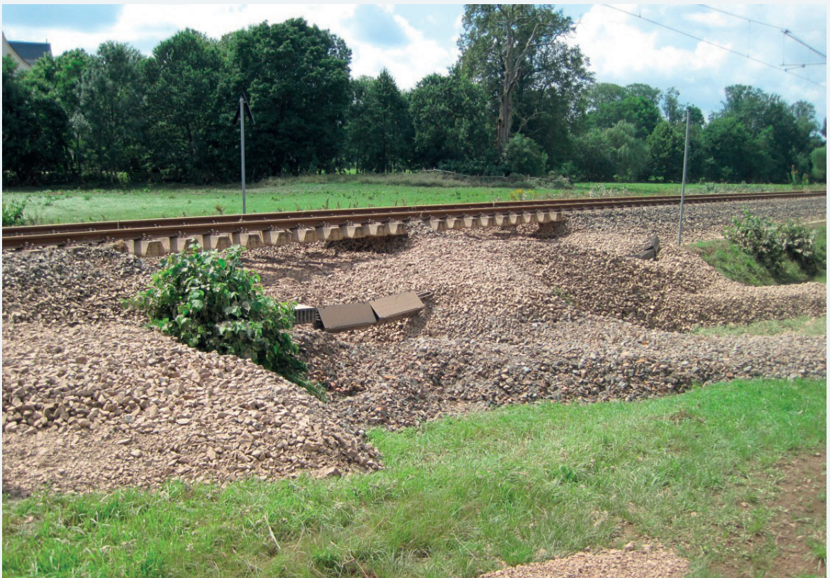
Abbildung 6-12: starke Erosionen im Bereich der Bahnstrecke Chemnitz-Stollberg (Foto: LTV)
