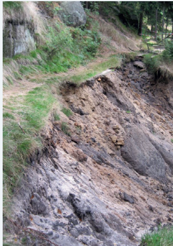
Abbildung 6-32: Schäden am Körtingweg (Zittauer Stadtwald) durch wild abfließendes Wasser während der Starkniederschläge des 06.08. und 07.08.2010 (Foto: Stadtverwaltung Zittau)
