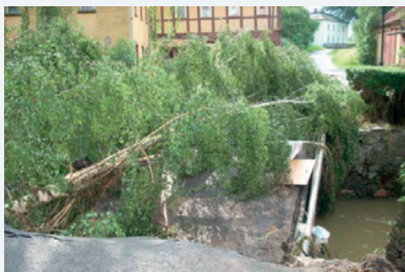
Abbildung 9-68: Zerstörte Brücke an der Heinstraße (Foto: Bertsdorfer Heimatverein e. V.)
