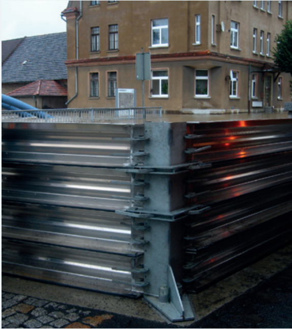
Abbildung 9-6: Ostritz, aufgebauter mobiler Hochwasserschutz an der Bahnhofstraße/Turbinengraben am 07.08.2010, gegen 17:00 Uhr (Foto: LDS)
