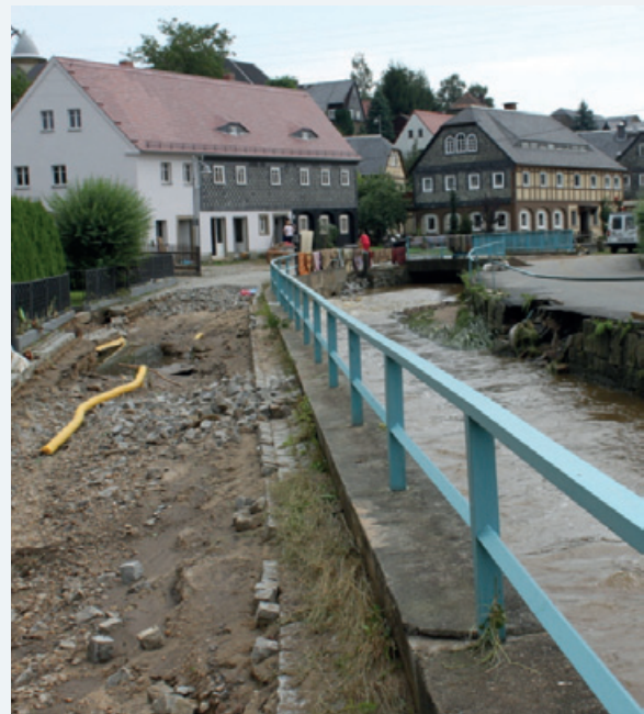
Abbildung 9-85: Zerstörter Erlenweg in Cunewalde mit S 115 (Foto: Gemeinde Cunewalde)
