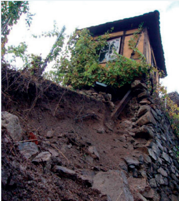
Abbildung 6-29: Zerstörte Weinbergmauer unterhalb des Spitzhauses in Radebeul (Foto: F. Aust)
