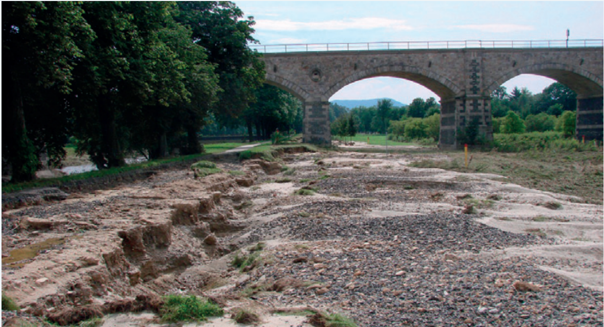
Abbildung 6-14: Durch rückschreitende Erosion nach Überströmung geschädigter Deich in Zittau (Foto: LTV)
