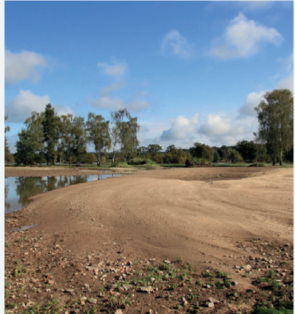
Abbildung 6-20: Sand- und Kiesauflage auf den Flächen der AG Zodel (Foto: R. Forker)
